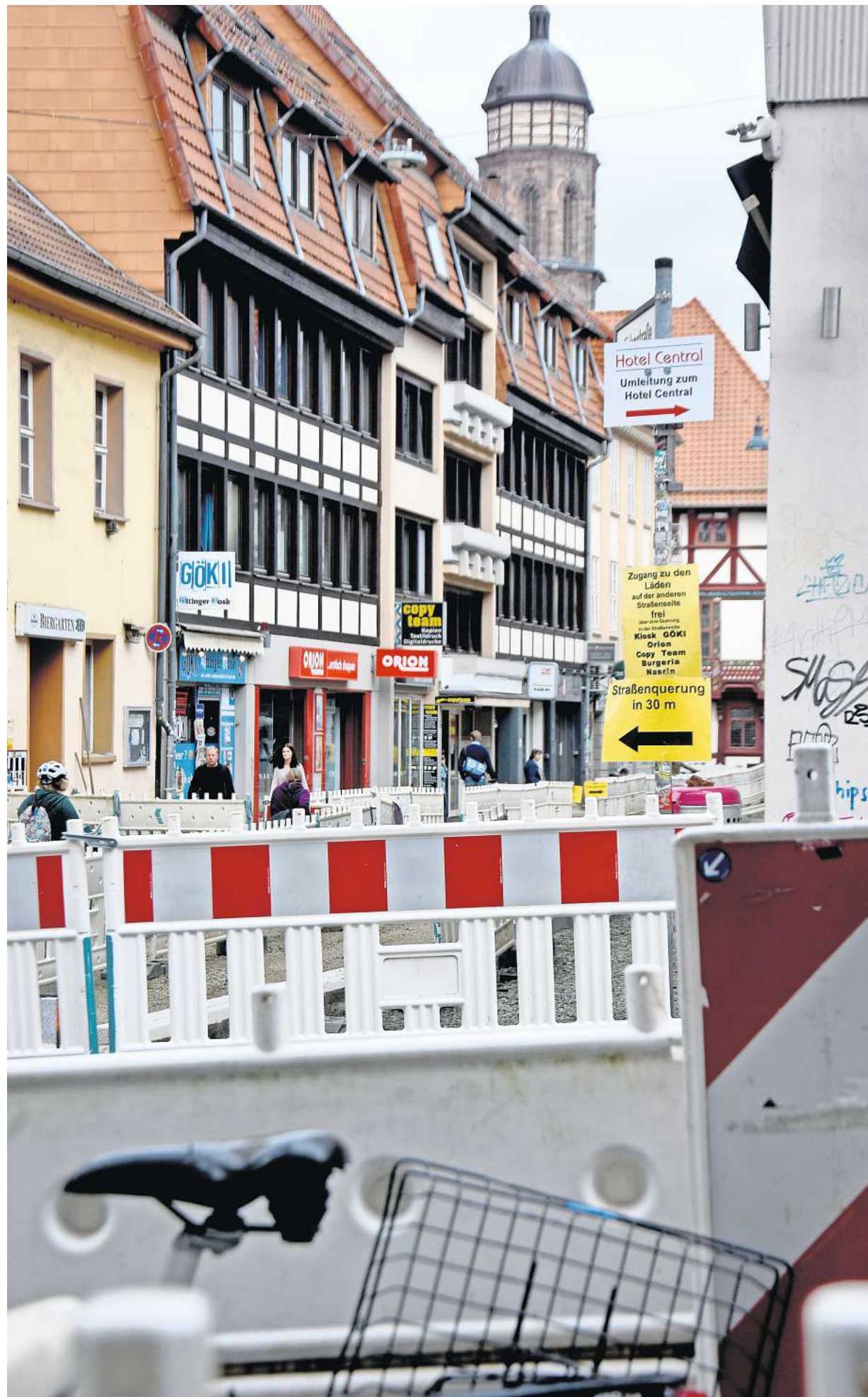
An der Judenstraße wurden weitere Bereiche gesperrt.
