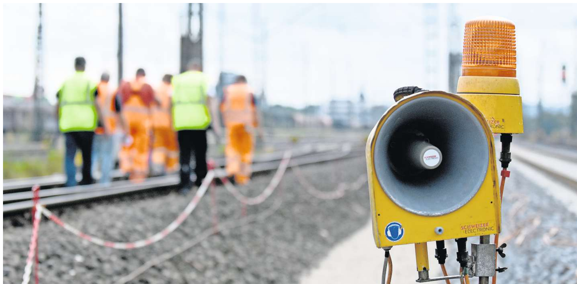
Laut, schrill und für die Arbeiter am Gleis (über-)lebenswichtig: die Rottenwarnanlage.
