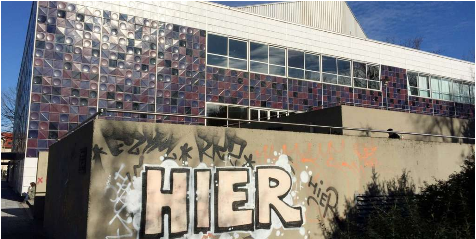
Die Stadthalle Göttingen soll saniert werden: Angesichts steigender Kosten wird jetzt wieder über einen möglichen Neubau diskutiert. Foto: Thomas Kopietz
