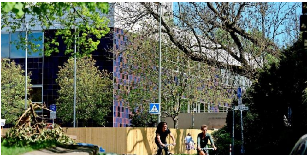
Bereit für die Kernsanierung: die Stadthalle Göttingen in der Bauphase mit Bauzaun. Quelle: Christina Hinzmann
